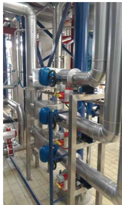
糖化锅蒸汽疏水阀组：并列竖直安装，节省底部空间，操作维护方便。
