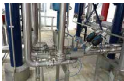
糖化锅投料水在线调温系统
